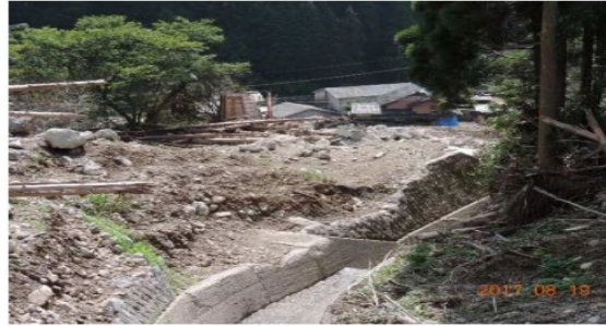
写真-2.16 流路工沿いの被災状況
