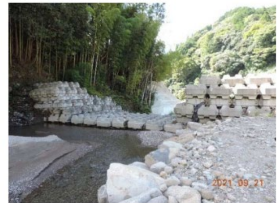
写真-2.8 ブロック積み仮復旧堰堤 背面
