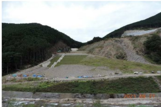
写真-1.10 押さえ盛土工の現状
