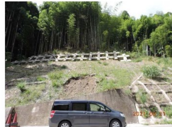
写真-3.6 隣接復旧箇所での脚部の崩壊
