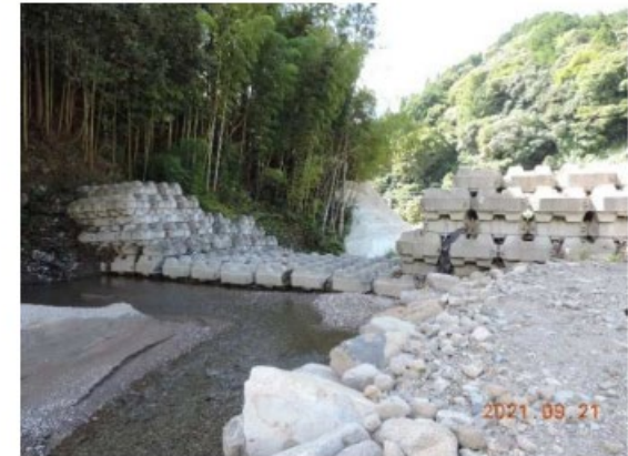
写真-2.8 ブロック積み仮復旧堰堤 背面
