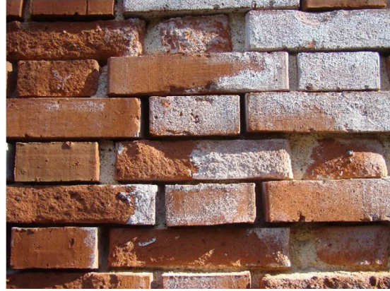
写真-6 左写真の壁近景 灰白色の目地材(後から補修?)
