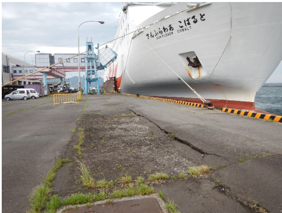
写真-1 沈下箇所
