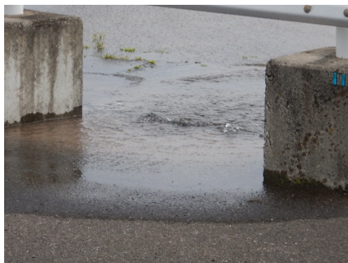
写真-4 亀裂からの噴水
