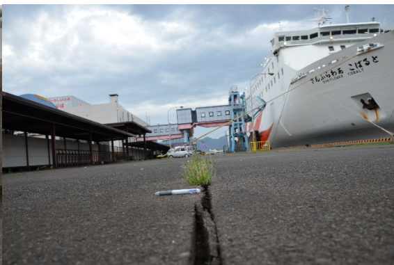
写真-5 沈下箇所周辺の亀裂
