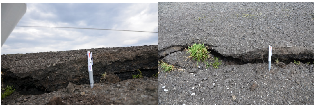
写真-2 沈下箇所の段差
